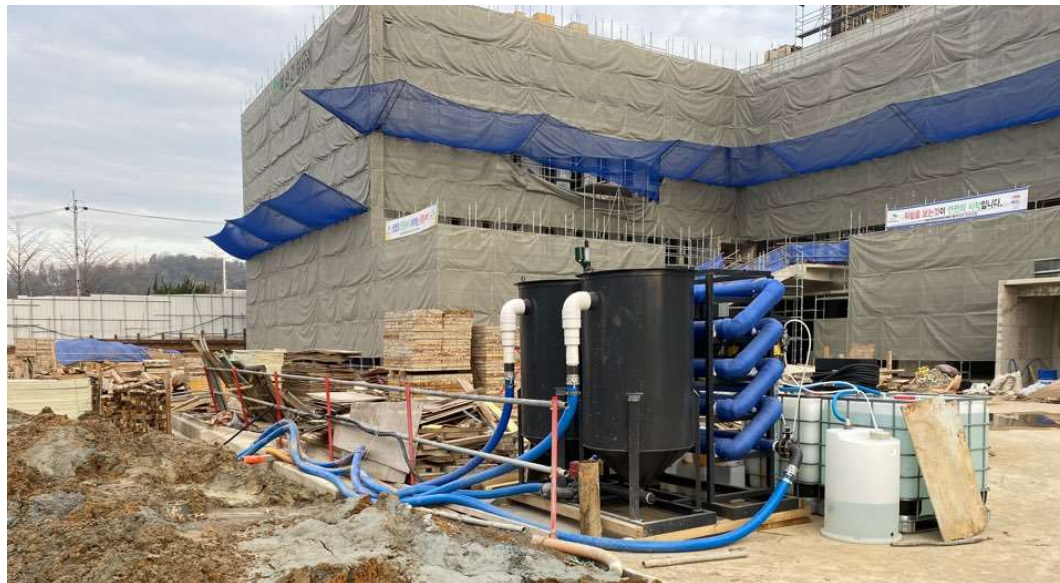
오탉수 처리 방류현장 (광주 현장)
